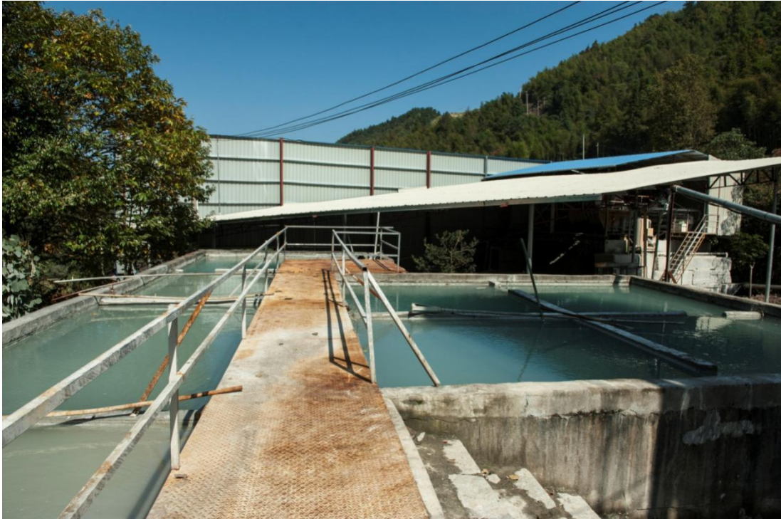
图 3-10 污水处理塔、沉淀池
