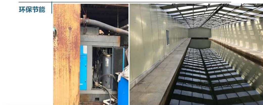
图 3-13 半岭采场空压机（左）及游泳池（右）
