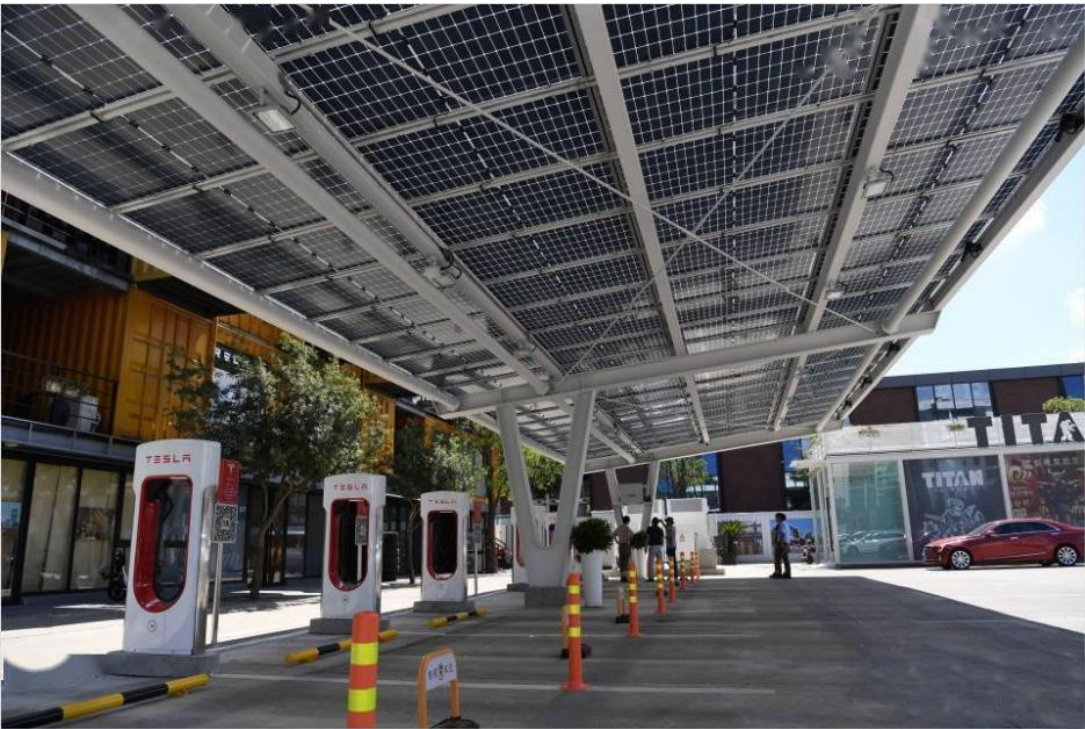
图 7-1 “光储充”一体化新能源充电示范站
